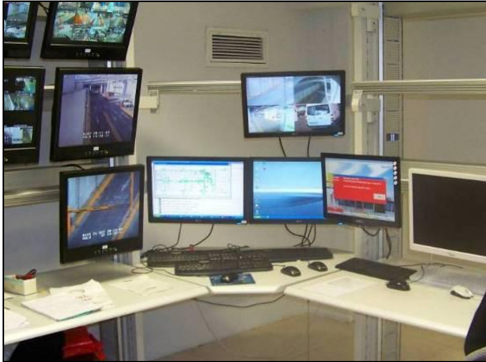
Εικόνα 20: BMS στο Golden Hall
