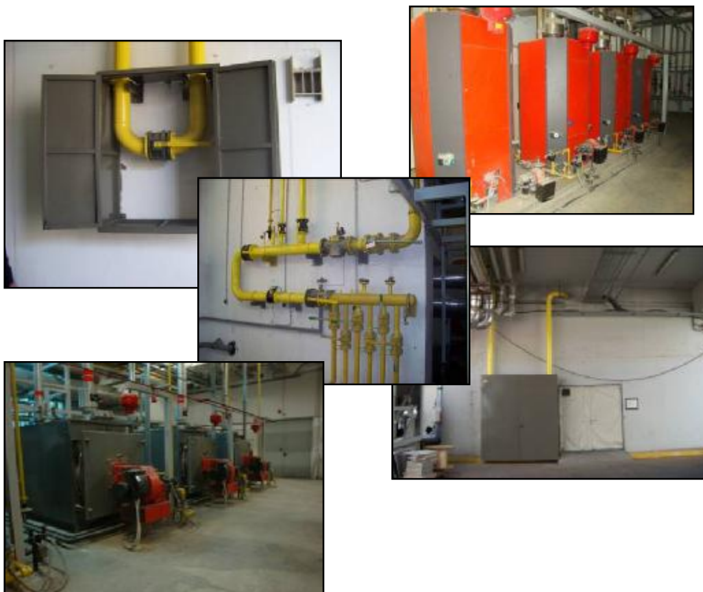
Εικόνα 19: Εγκαταστάσεις φυσικού αερίου στο Golden Hall
