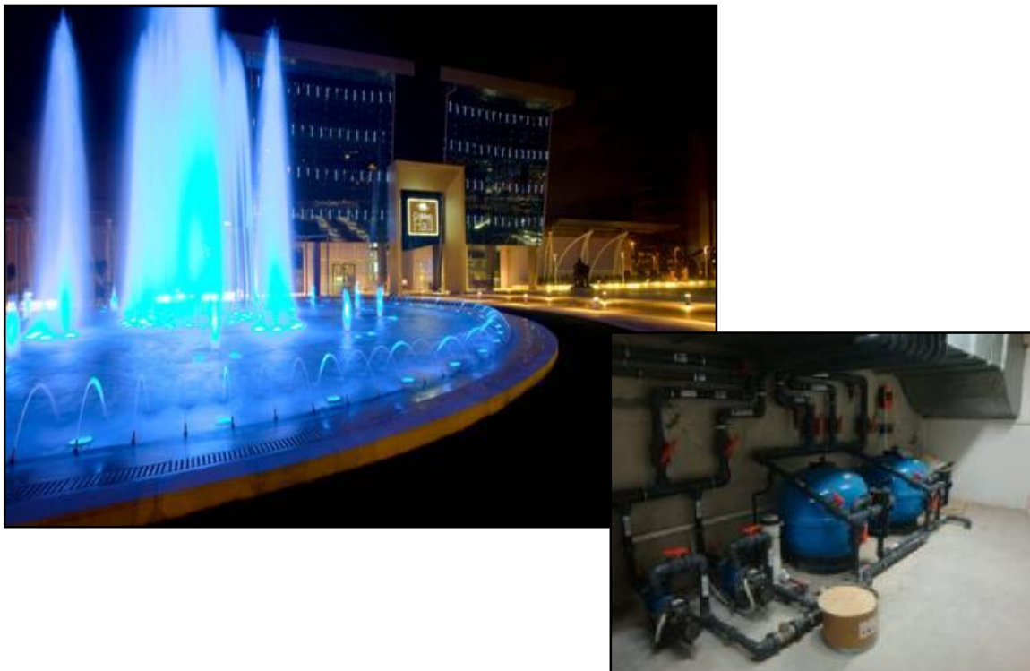
Εικόνα 18: Σύστημα καθαρισμού και ανακύκλωσης της λίμνης στο χώρο του Golden Hall
